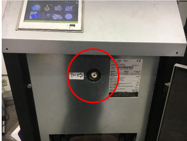
Kessel von vorne mit offener Türe
