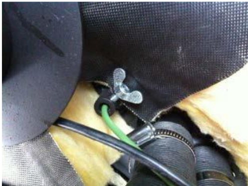
Brennraum Fühler (Kessel von hinten)
