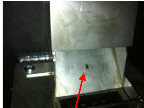
Brennraum Fühler (Ansicht vom Brennraum)
